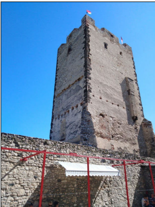
Obr. 17: Pohled na západní stěnu obytné věže s trámovými otvory stropu prvního patra a s otiskem stropu druhého patra (foto autor 2019).
