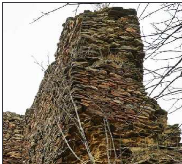
Pajrek (okr. Klatovy), donjon, severní zeď se špaletami.
